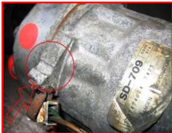
Upevňovací body poškozeny
